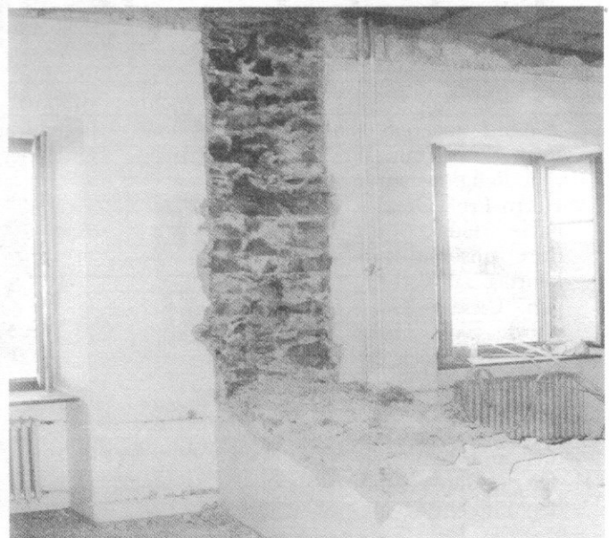
Zwischenwandabruch 2. Stock, Nord.
